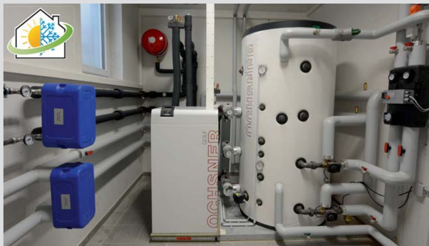
Blitzsaubere Handwerksleistung, eine Wärmepumpe „made by Pfab“. Das Heizkreissystem wird über moderne Pumpentechnologie der Effizienzklasse „A“ versorgt.
